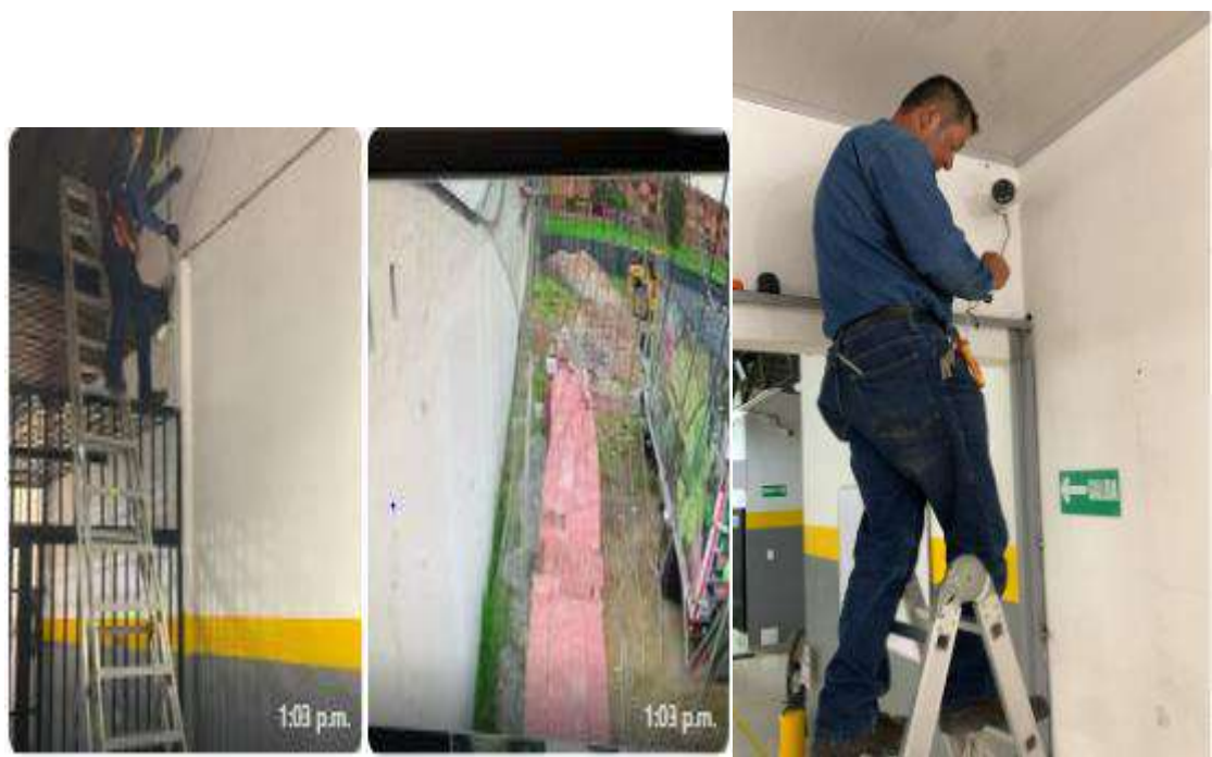
Instalación de 4 cámaras variante chía cota CTP
