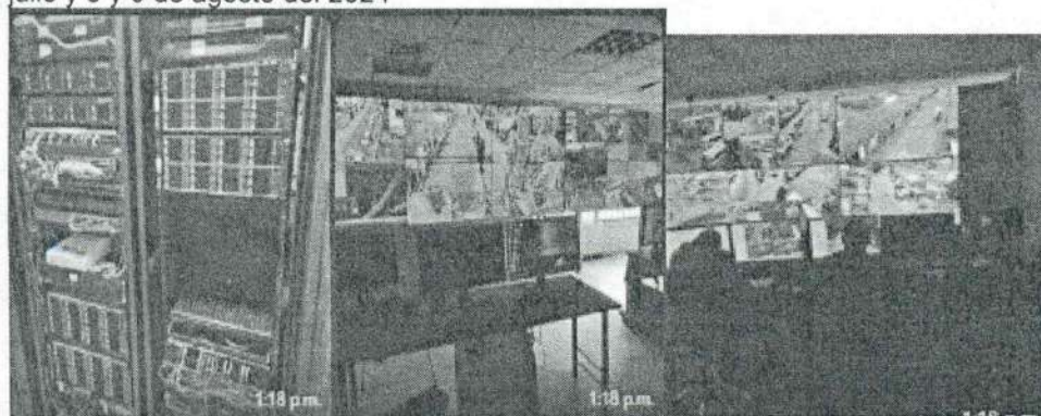
Mantenimiento de equipos central de emergencias alcaldía municipal de chía los días 16, 19, 27 de julio y 6 y 9 de agosto del 2024
