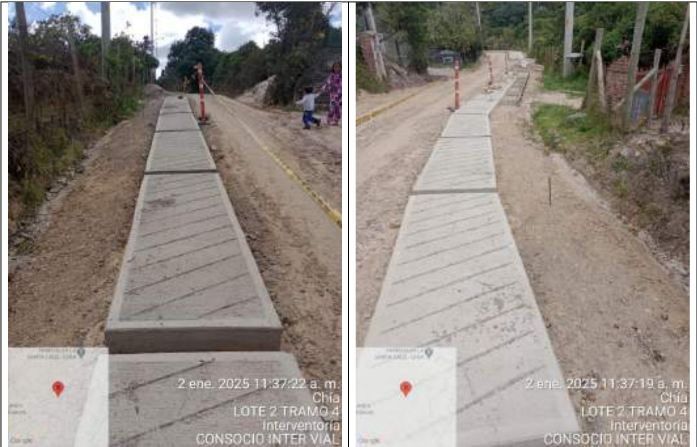
Evidencia de no presencia de trabajadores y señalización Tramo 4 - Sector Puente San Fermin
